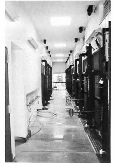
セカンドキャッチ、2重施錠、落としピンにカーブミラー、安全対策には気をつけています。給水栓は壁面埋込。
