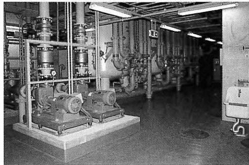
地下に設置された巨大なろ過装置
